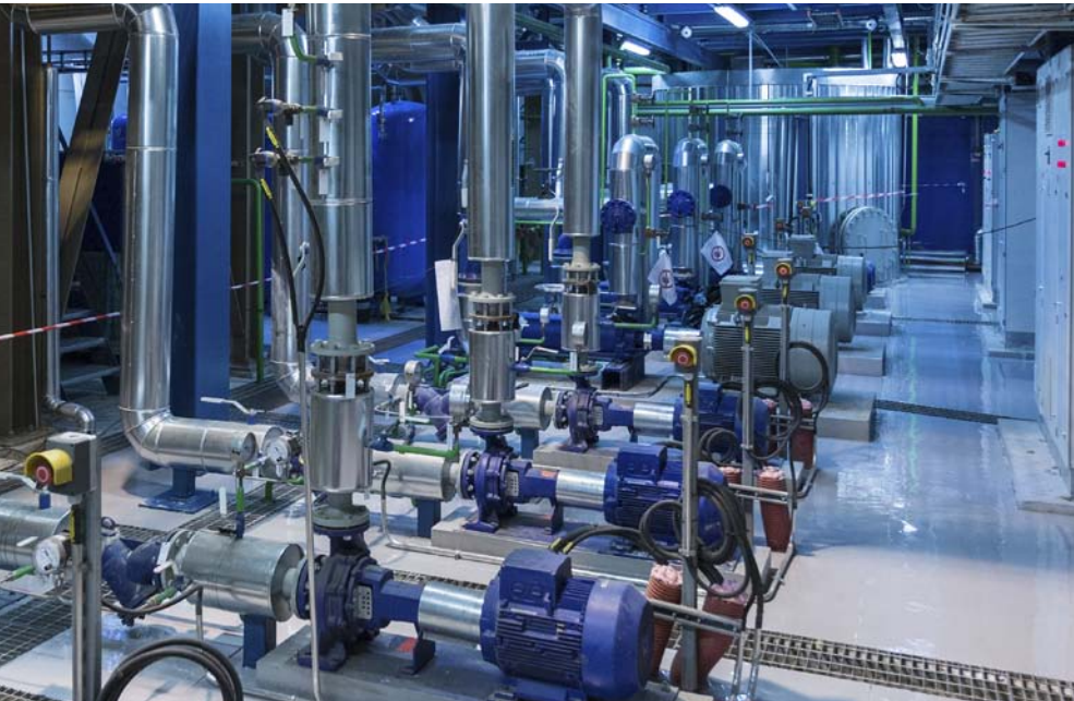
Aplicación de bombas, p.ej. ahorro de energía en la automatización de edificios con variadores de frecuencia
